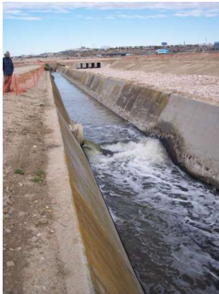
Canal de salida EDAR Sur-Oriental. Arroyo de los Migueles. Rivas Vaciamadrid
